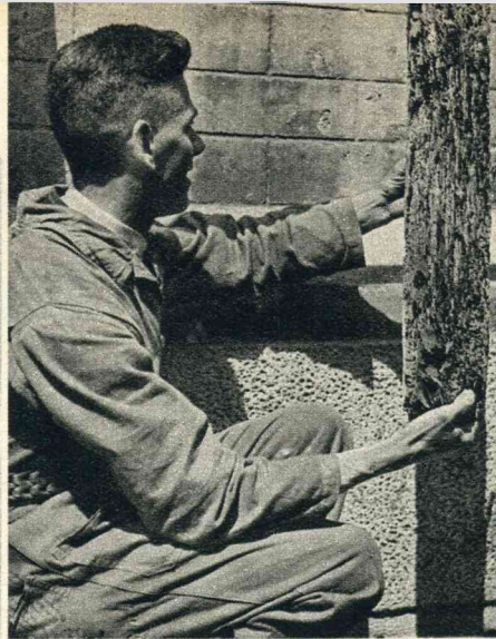
Als het houtwerk er langzamerhand zóó is gaan uitzien, geen wonder, dat dan een grondige restauratie ter hand moest worden genomen.
