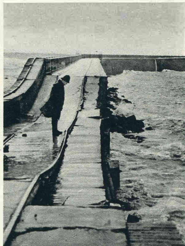
Een gedeelte van het havenhoofd te Scheveningen is bij den laatsten storm over een lengte van 30 meter verzaakt.
