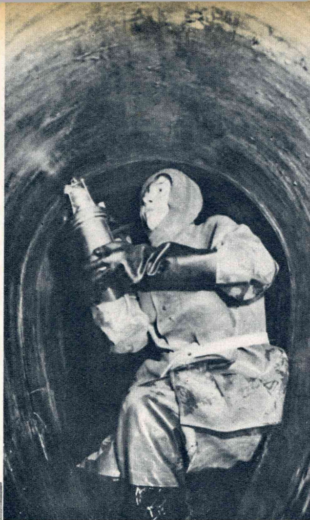
In het hoofdriool van Amsterdam. Met behulp van een veiligheidslamp zoekt de arbeider naar scheuren of lekken in het riool. Hij hurkt in het drabblge water, rustend tegen den glibberigen wand, en slechts het kleine lamp-lichtje verlicht de diepe, stinkende duisternis.
