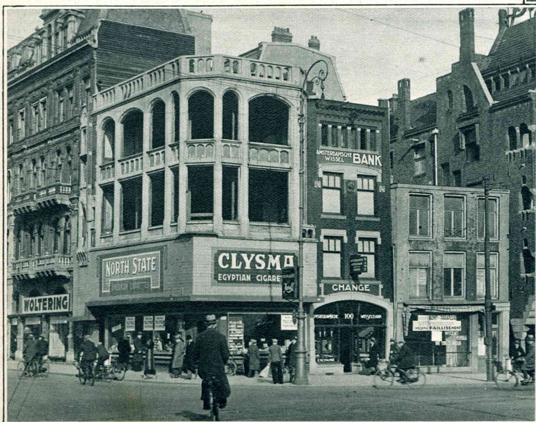
De „Bisschop-ruïne” wordt gesloopt. Eindelijk is dan 'n begin gemaakt met de afbraak van de onooglijke ruïne op den hoek van den Dam en het Damrak. Gelijk de meeste Amsterdammers zich zullen herinneren, is op dezen hoek het bekende café „De Bisschop” gevestigd geweest; de twee eerste panden op het Damrak, waar eens de sigarenwinkel van Justus van Maurik en een zaak van den boekhandelaar Seyffardt waren gevestigd, worden eveneens gesloopt. Ter plaatse zal een kantoor-gebouw verrijzen, waarin o.a. de incassobank 'n bijkantoor zal openen.
