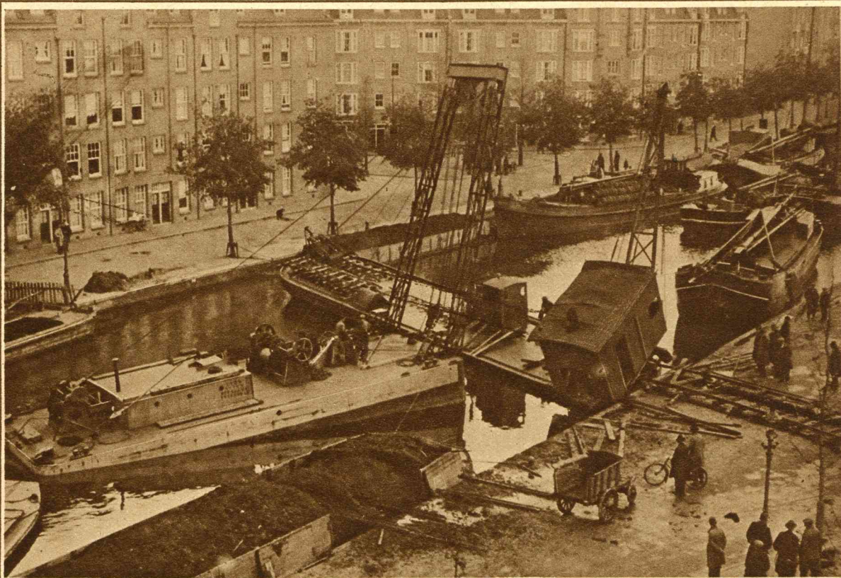
Vrijdag j.l. viel aan de Kostverlorenvaart te Amsterdam een zware kraan dwars over het water, waardoor het verkeer te water gestremd is. Men is bezig het gevaarte te lichten.
