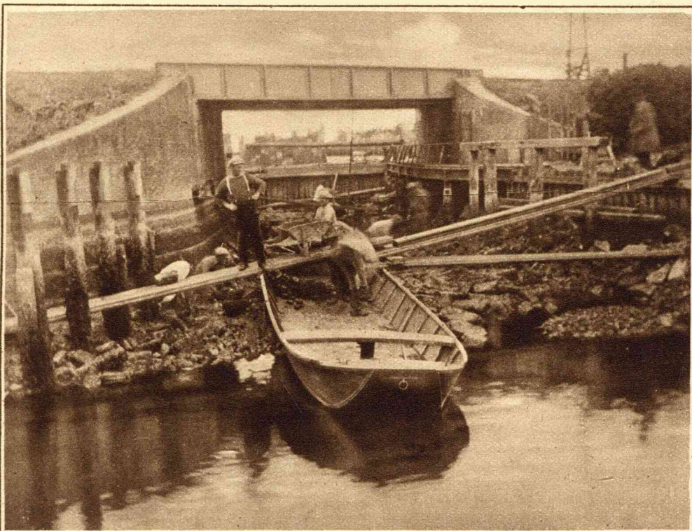
HEER HUGOWAARD. Het herstel van het landhoofd der spoorbrug over de Ringsloot, dat op twee plaatsen gescheurd is. De Ringsloot is geheel drooggelegd.
