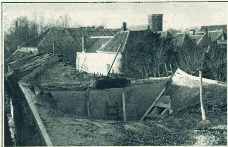
Het ingestorte dak met het weggeslagen platte dak door de bakkerij.
