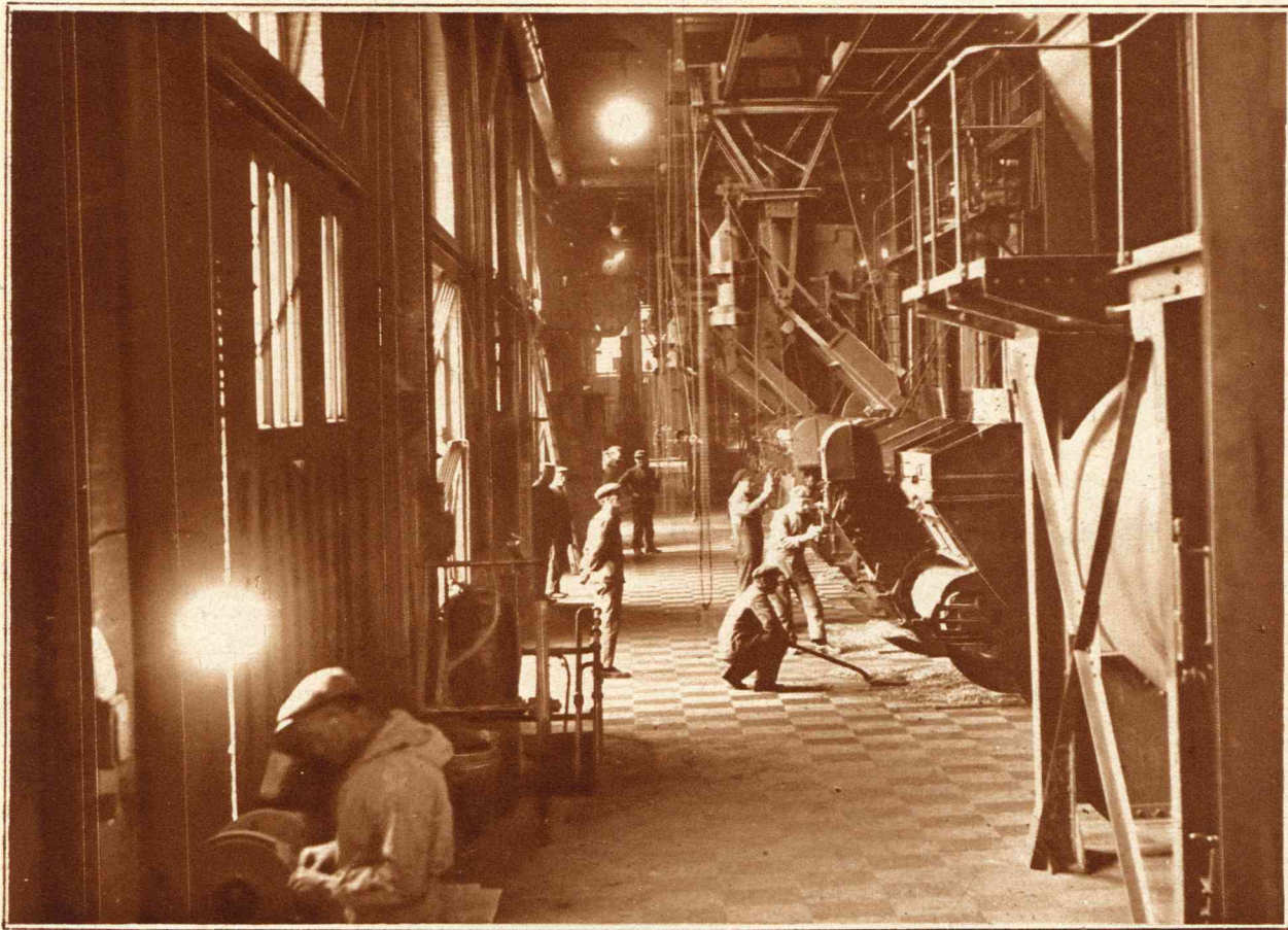
Een schilderachtig doorkijkje in een der ketelhuizen. Elk van de ketels, waarvan sommige een capaciteit hebben van 65000 K.G. stoom per uur, wordt door één man bediend. Men ziet rechts op den voorgrond een kettingrooster, waarbij een der stokers bezig is eenige overgebleven aschresten op te scheppen.
