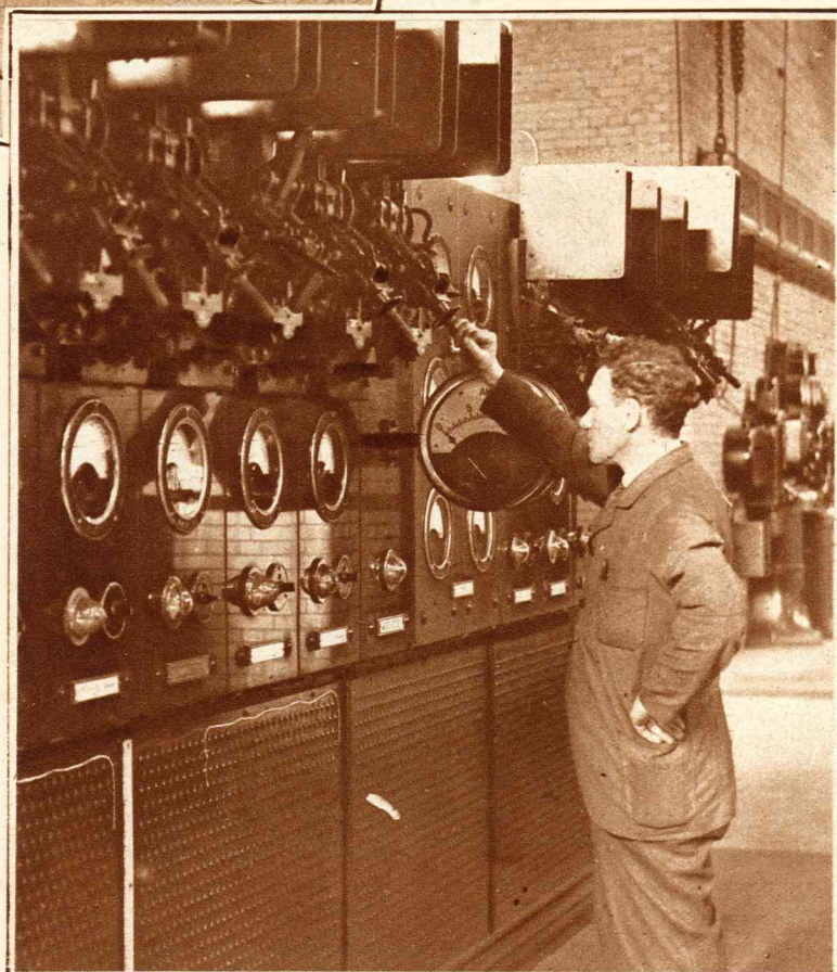
Hier ziet men het schakelbord, vanwaar speciaal de Rotterdamsche tram wordt bediend. De wijzer onder den rechterarm van den beambte toont de gebeurtenissen op het tramnet met verrassende duidelijkheid aan. Wordt hier een ernstig incident geconstateerd, dan kan onmiddellijk uitschakeling van stroom met een enkele handbeweging plaats vinden op het betrokken netgedeelte.
