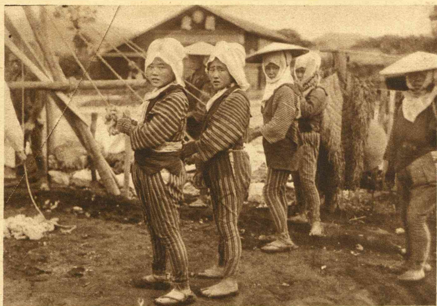
Japansche vrouwen aan het heien. — In Tokio kan geen huis worden gebouwd zonder de noodige heipalen.
